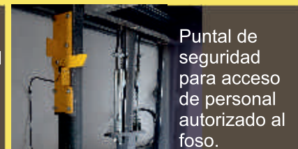
Stop de seguridad en foso.
